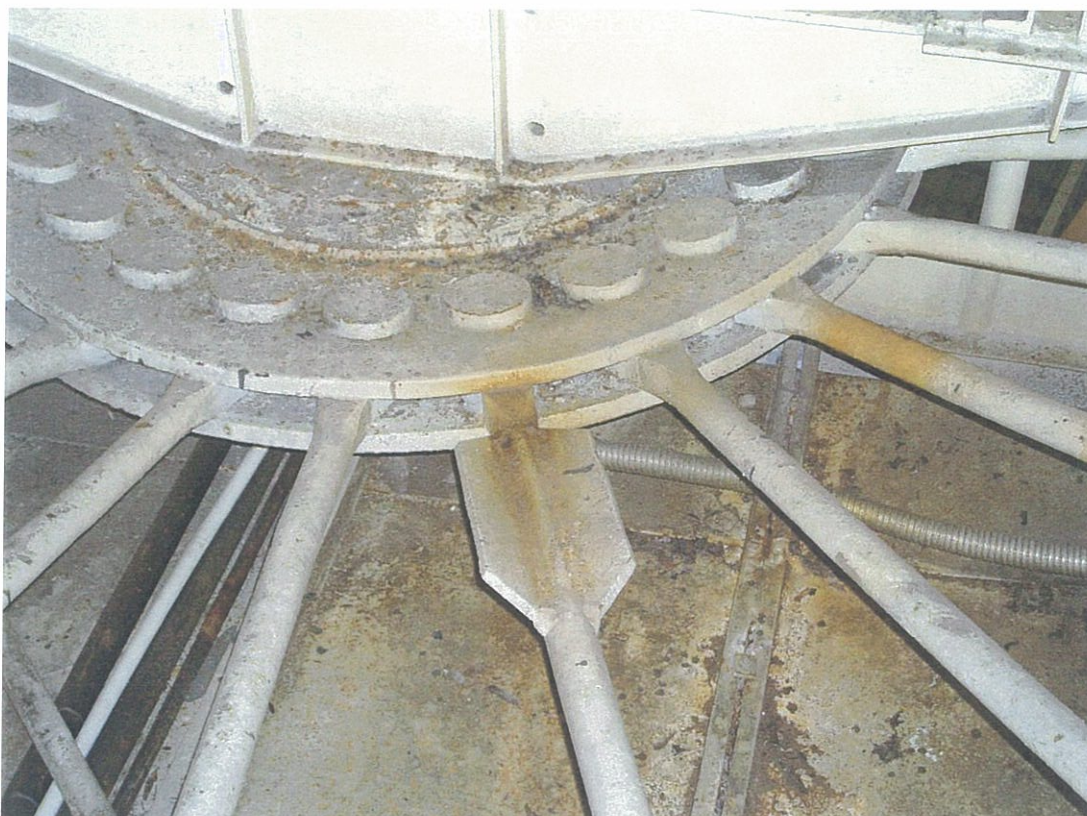
Fot. 9 Uszkodzenia korozyjne mocowania ciągów w „talerzu” (,7” – rys.1)
