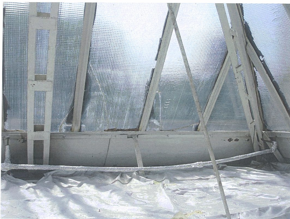
Fot. 3 Widok pęknięć tafli szklanych od wnętrza świetlika
