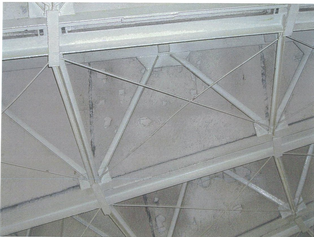
Fot. 7 Uszkodzenia tynku cementowo – azbestowego od spodu płyt dachowych
