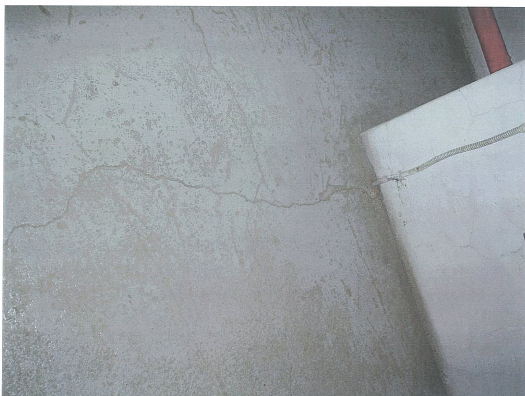
Fot.30 Spękania posadzki rotundy
