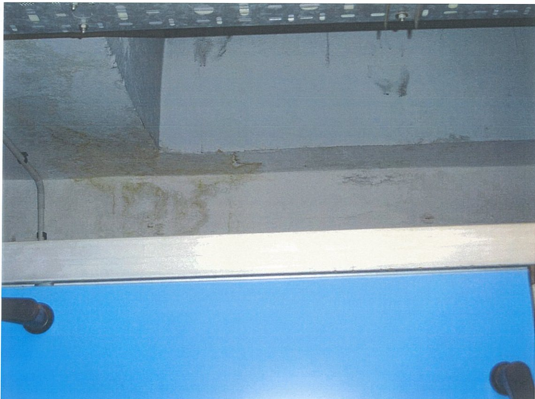
Fot. 70 Zacieki na podstawie świetlika nad aparaturą klimatyzacyjną.
