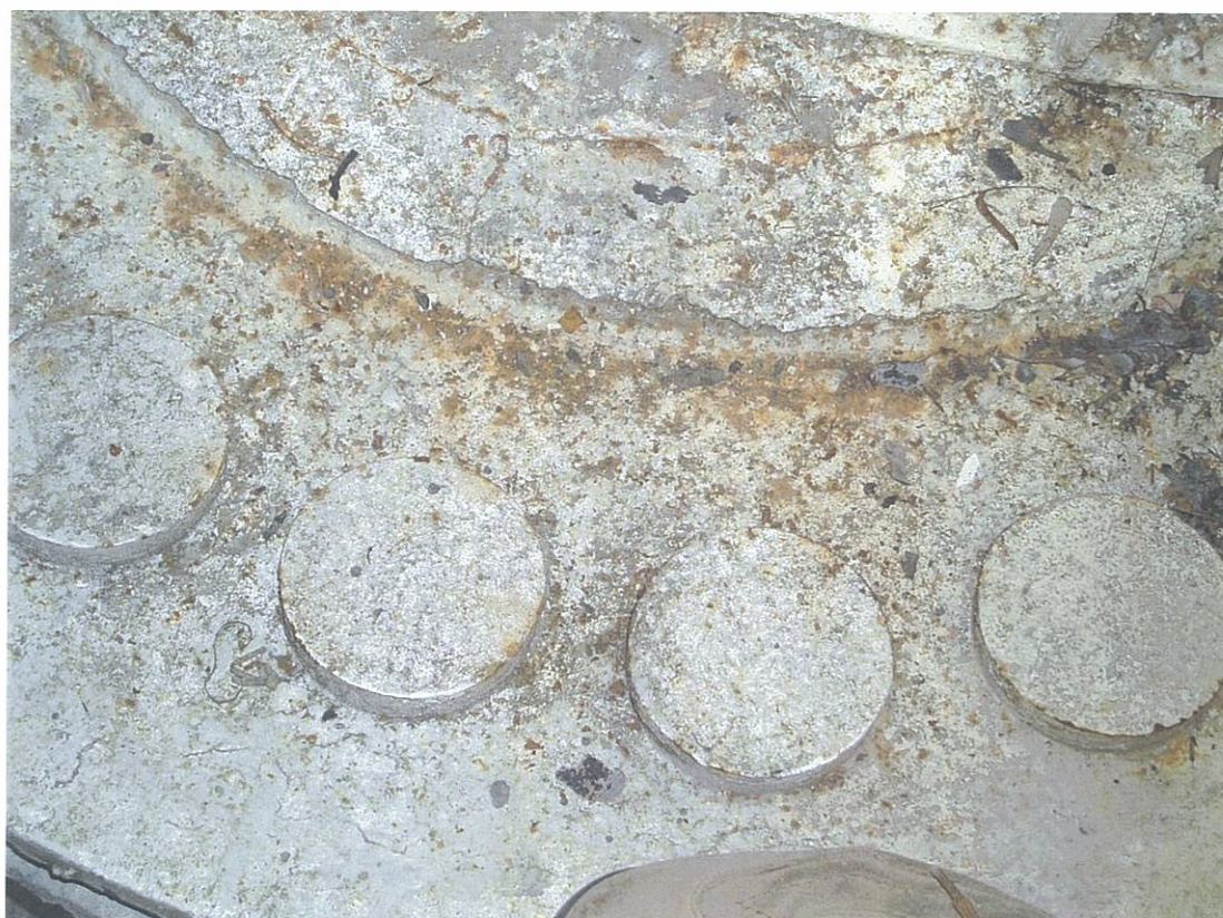
Fot. 10 Uszkodzenia korozyjne mocowania ciągów w „talerzu” – detale
