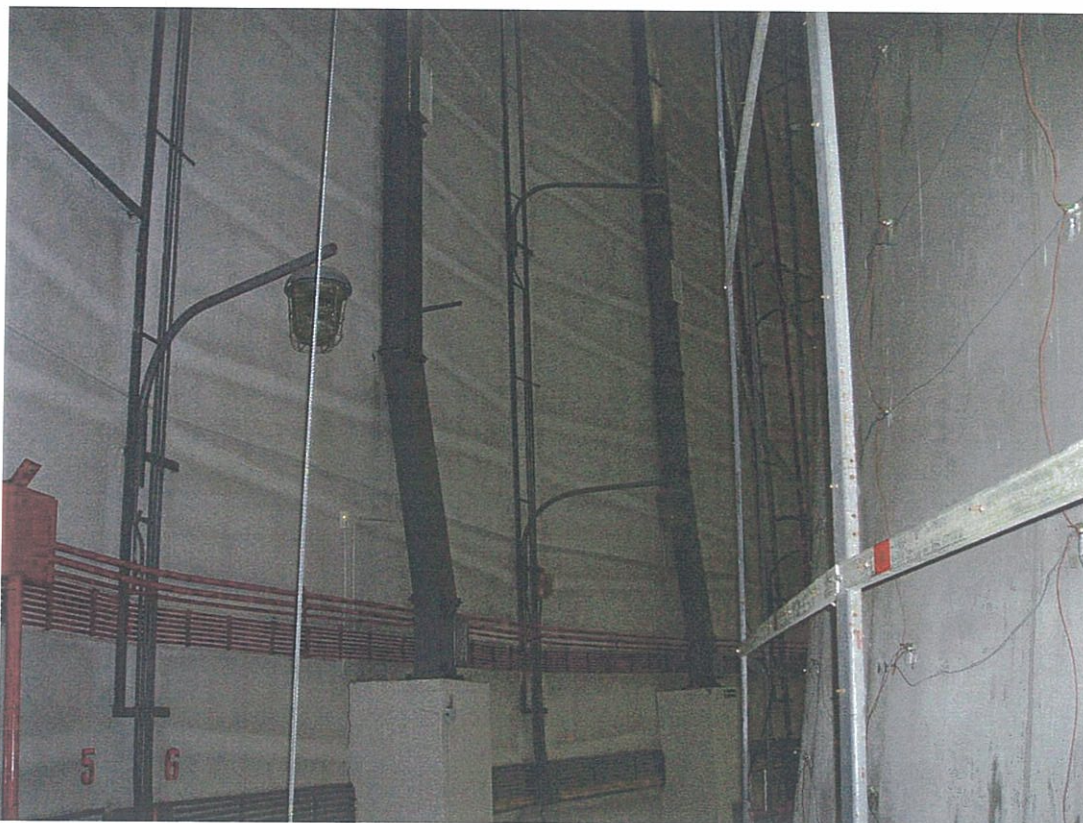
Fot.23 Ślady przemarzania na wewnętrznej powierzchni płyt
