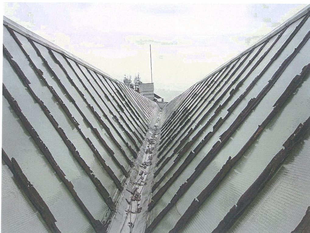
Fot. 4 Widok rozsypujących się taśm uszczelniających złącza tafli świetlików
