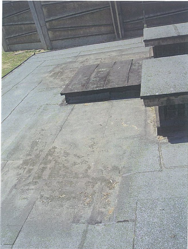
Fot. 63 Ślady zastoju wody opadowej przy luku montażowym na dachu budynku zaplecza technicznego
