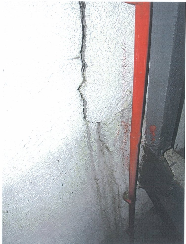
Rys.26 Kilkumilimetrowe narastające (rozsadzane przez korzenie pnączy) pęknięcie na krawędzi słupa ze śladami wody opadowej przenikającej do wnętrza rotundy
