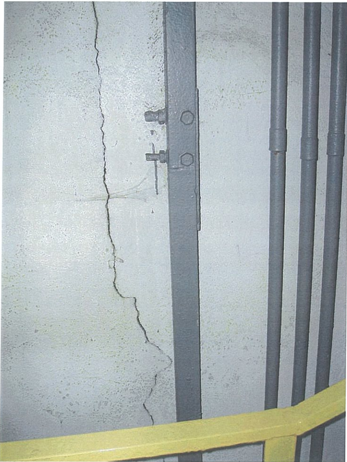
Rys.25 Narastające pęknięcie na krawędzi słupa
