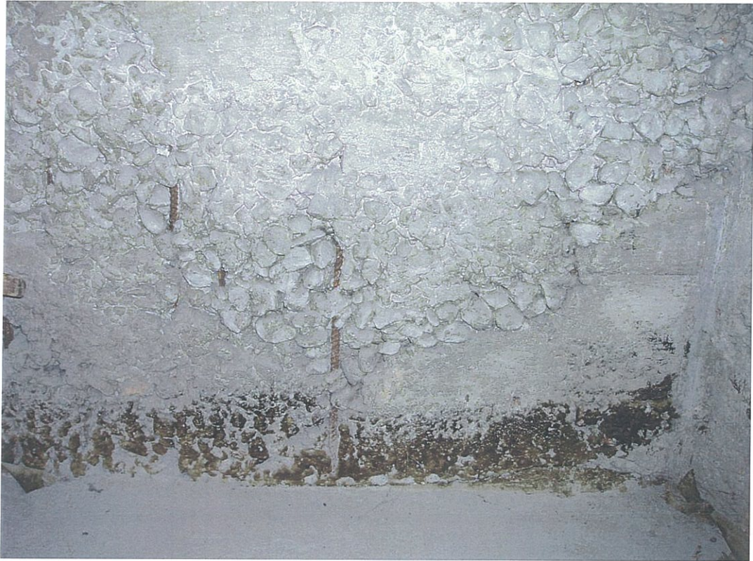
Fot.35 Brak właściwej otuliny prętów, niewłaściwy dobór i rozfrakcjonowanie kruszywa w betonie konstrukcji nośnej schronu płótna Panoramy Raławickiej
