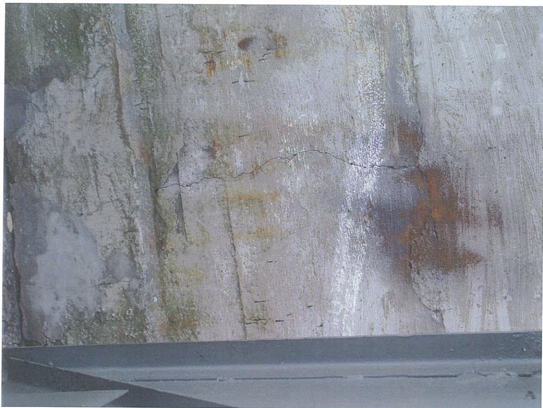
Fot.86 Pęknięcia poziome i pionowe ściany zewnętrznej wyjścia
