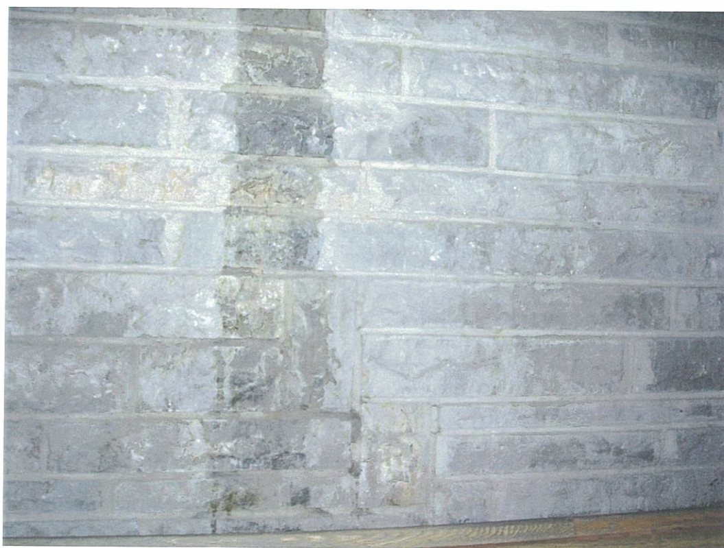
Fot.34 Ślady napraw pęknięcia wykładziny kamiennej na ścianie korytarza
