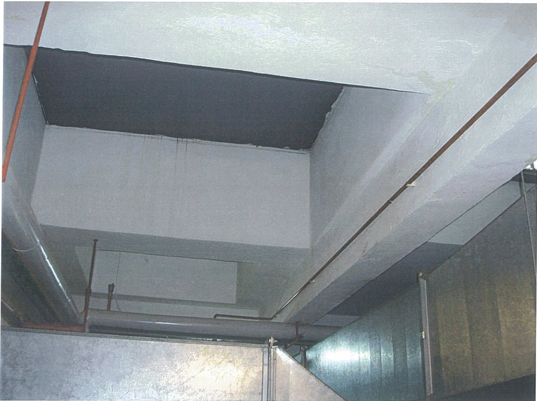
Fot. 69 Zacieki na ściankach podstawy luku montażowego
