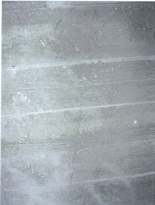
Fot. 36 Pęknięcia ścian żelbetowej konstrukcji nośnej schronu płótna Panoramy Raławickiej
