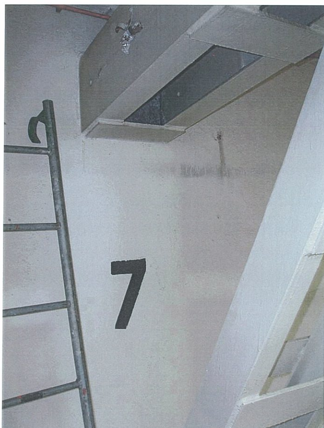
Fot.16 Niewielkie spękania ściany
