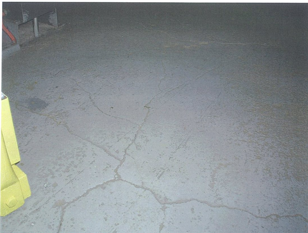
Fot.29 Spękania posadzki rotundy
