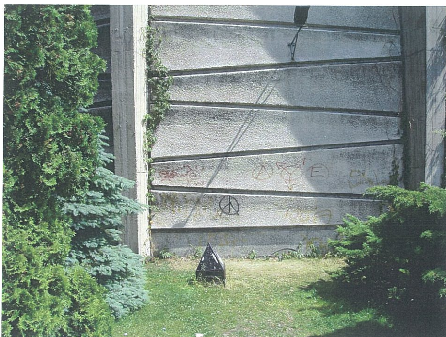
Fot.20 Pnącza oraz sgrafitti na ścianach zewnętrznych rotundy
