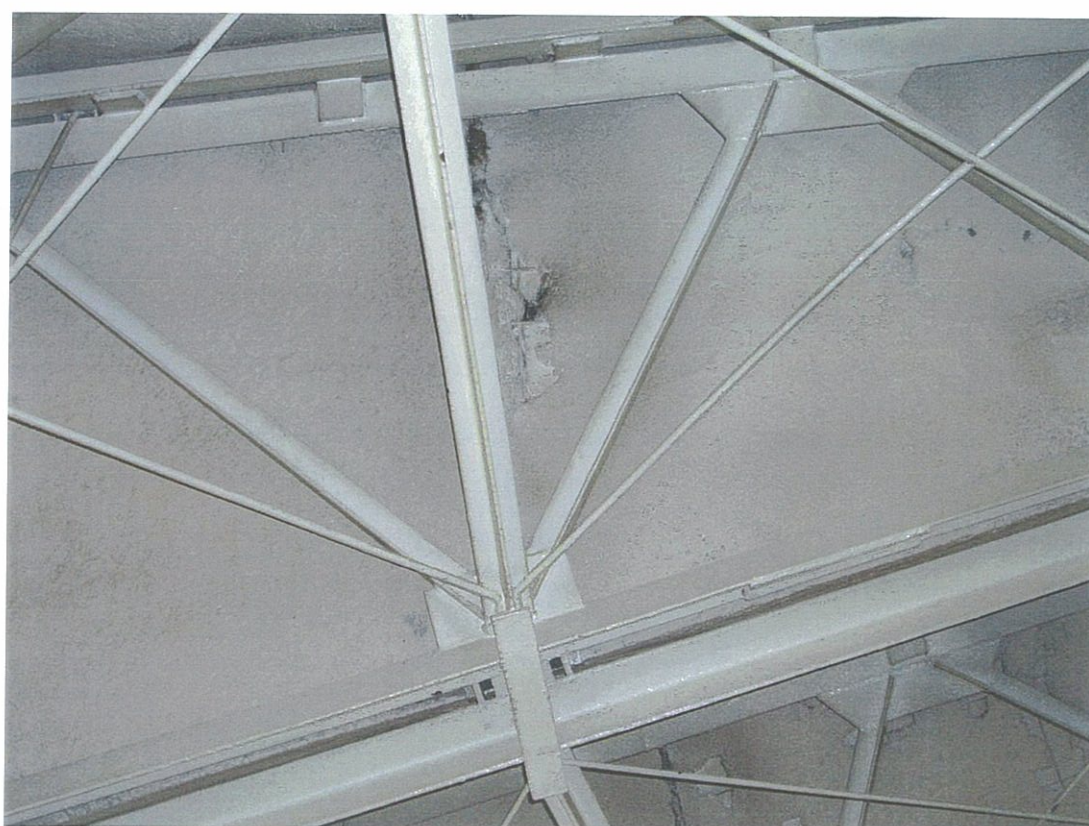
Fot. 8 Uszkodzenia tynku cementowo – azbestowego od spodu płyt dachowych
