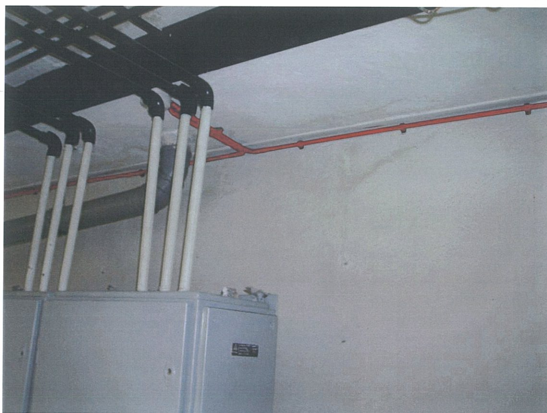
Fot.88 Zacieki nad aparaturą w pomieszczeniu
