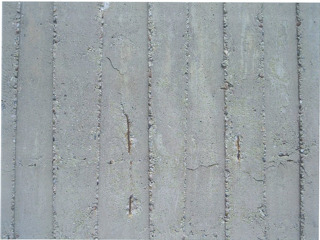
Fot. 54 Stan powierzchni żelbetowej ściany elewacyjnej
