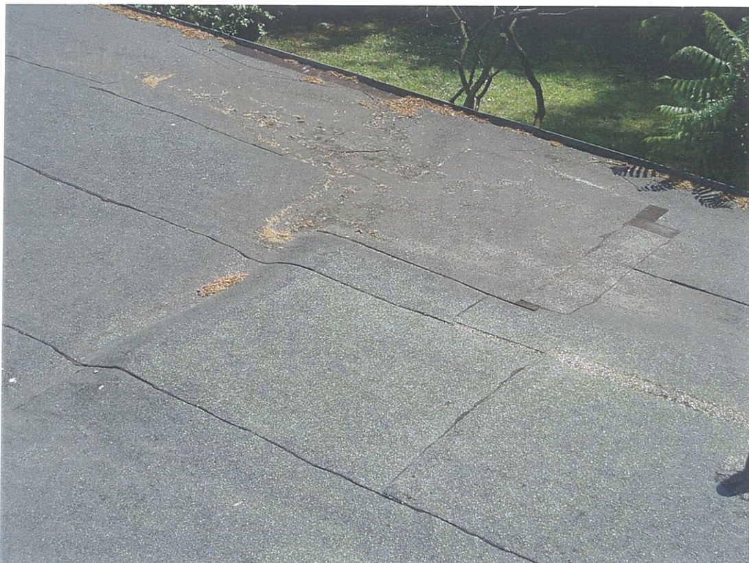
Fot. 67 Zapadlisko zastoiny spowodowane przeróbkami dachu
