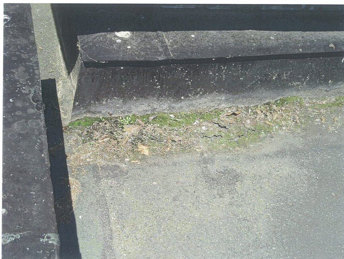
Fot. 66 Mech rosnący na krawędzi obróbki świetlika przy zapadlisku zastoiny
