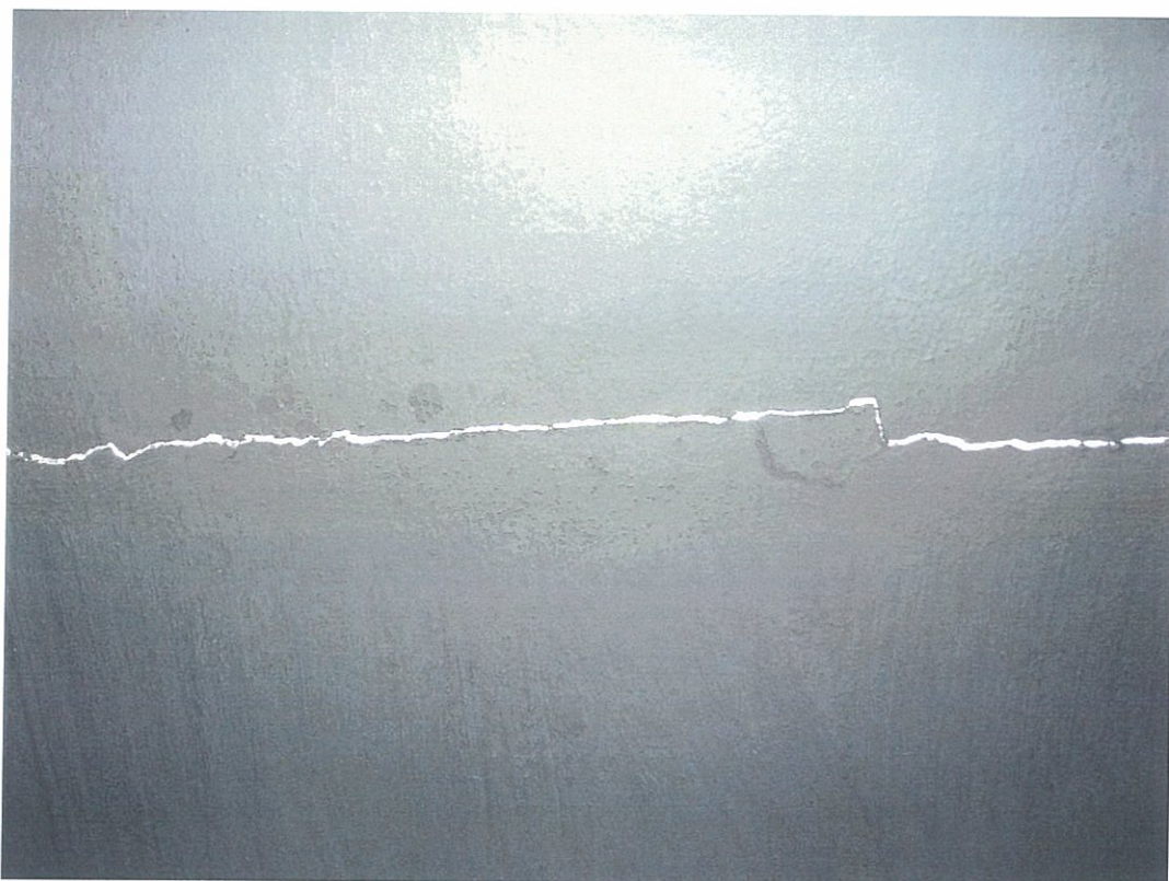
Fot.33 Pęknięcie na suficie korytarza ze śladami napraw
