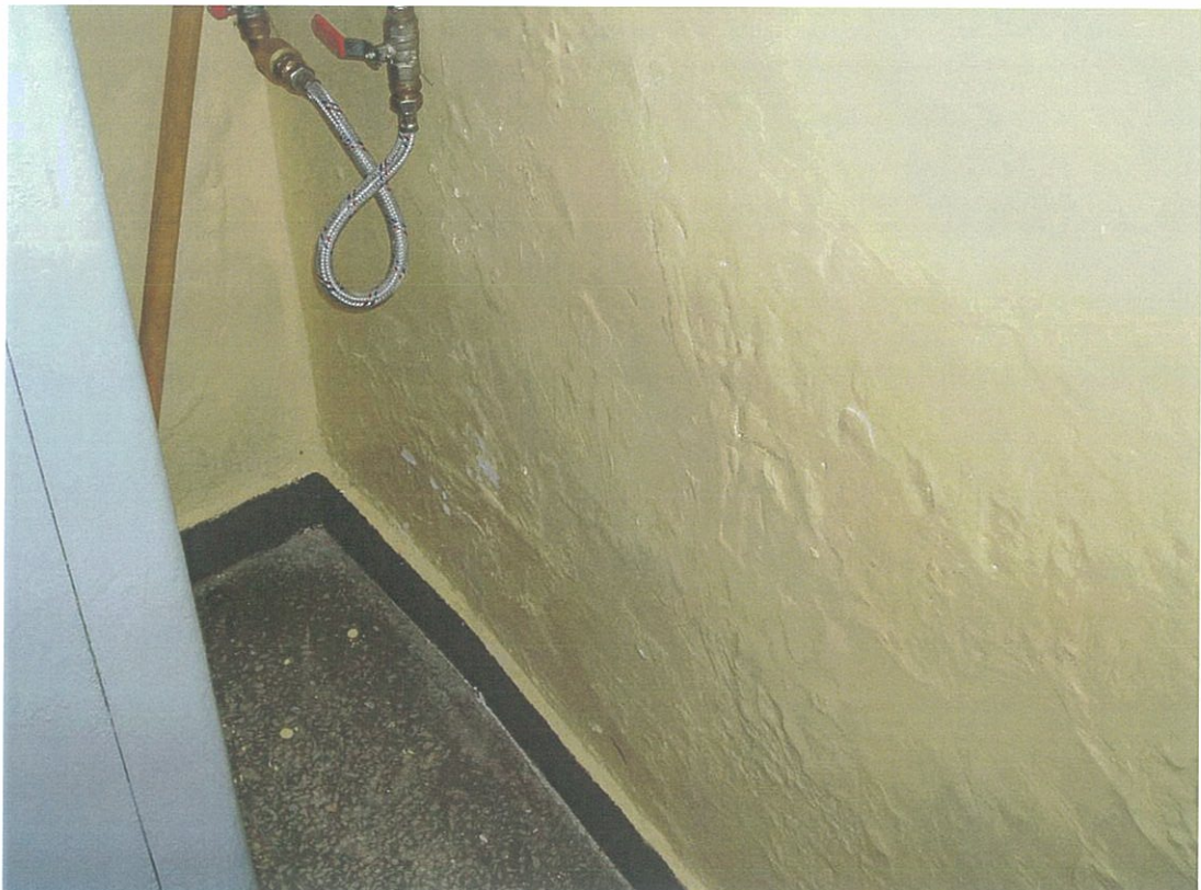
Fot. 84 Ślady podsiąkania wód gruntowych
