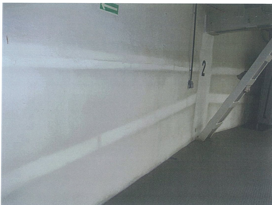
Fot.22 Ślady przemarzania i rysy na wewnętrznej powierzchni płyt nad galerią
