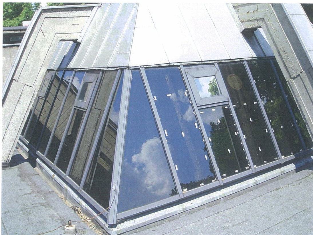
Fot. 68 Liście zatykające odprowadzenie wód opadowych świetlika
