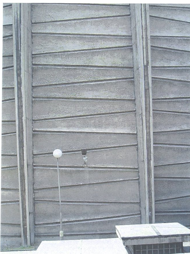
Fot.21 Ślady karbonizacji betonu na powierzchni płyt
