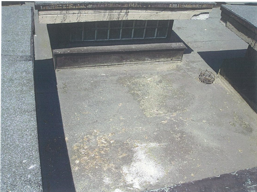
Fot. 64 Dewastacje spowodowane przez niepowołane osoby przebywające na dachu budynku zaplecza technicznego
