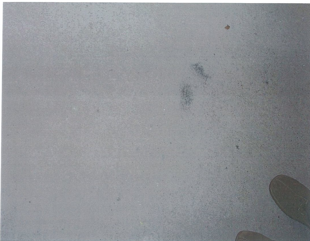
Fot.39 Ślady tzw. czarnej pleśni na betonowej posadzce schronu
