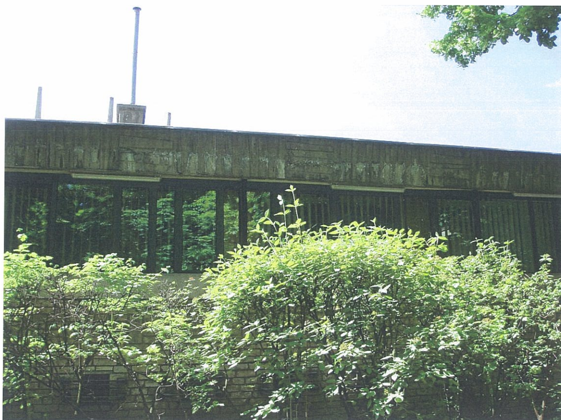
Fot. 56 Wykwity węglanu wapnia na żelbecie attyki od strony wschodniej
