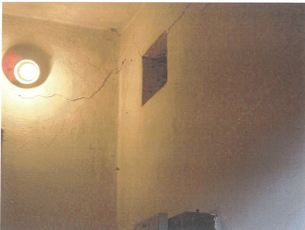
Fot. 81 Zarysowanie ściany nośnej przy południowo – wschodnim narożniku
