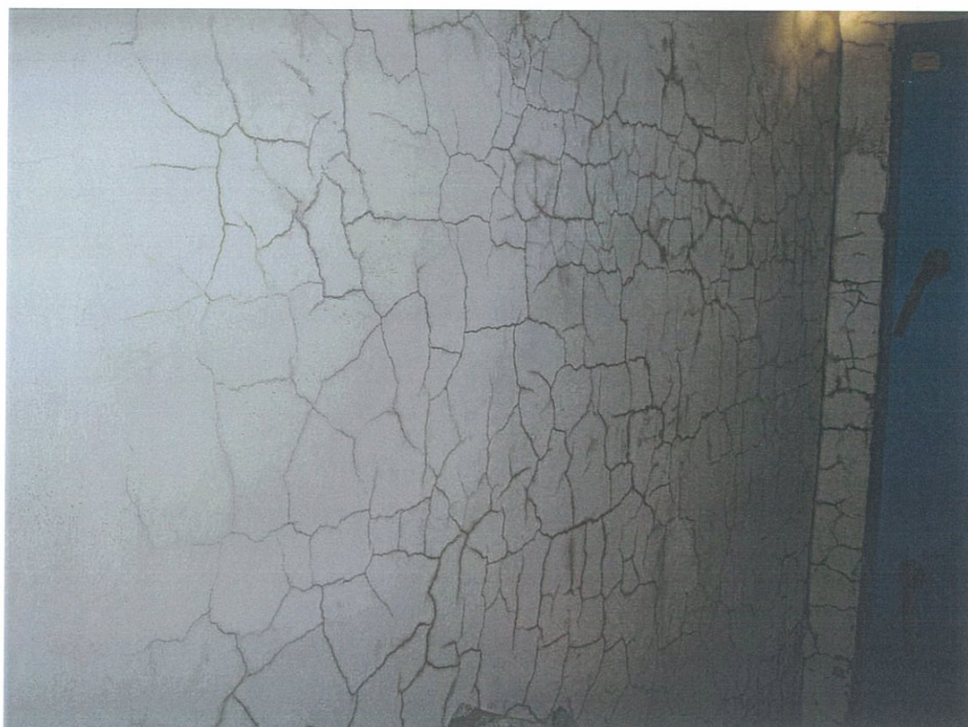
Fot. 76 Siatka spękań na ścianach pomieszczeń z aparaturą klimatyzacyjną
