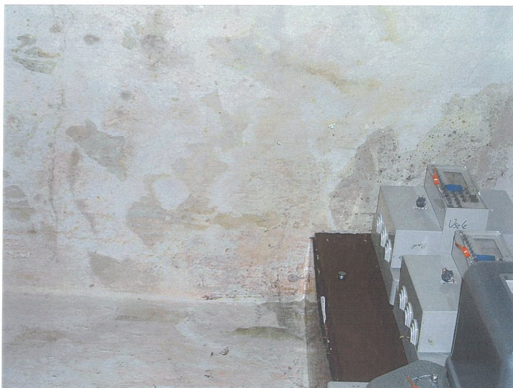
Fot. 82 Ślady podsiąkania wód gruntowych i przemarzania ściany
