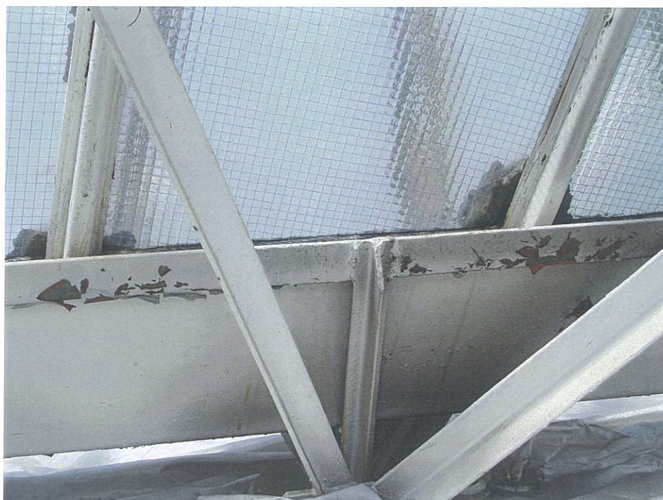
Fot. 6 Widok zniszczonych powłok malarskich od wnętrza świetlika
