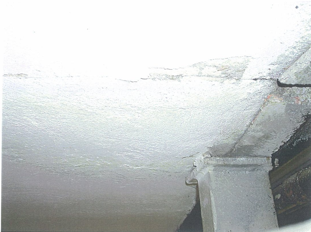
Fot.15 Niewielkie uszkodzenia dachu na galeryjką spowodowane dużym nierównomiernym obciążeniem na powierzchni dachu
