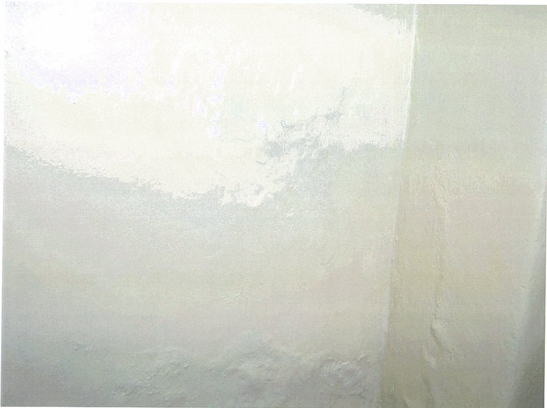
Fot. 85 Ślady podsiąkania wód gruntowych
