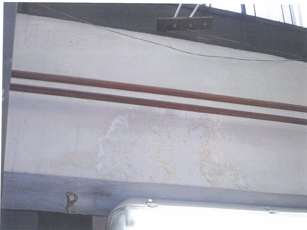
Fot.73 Zacieki na ścianie wewnętrznej podstawy świetlika
