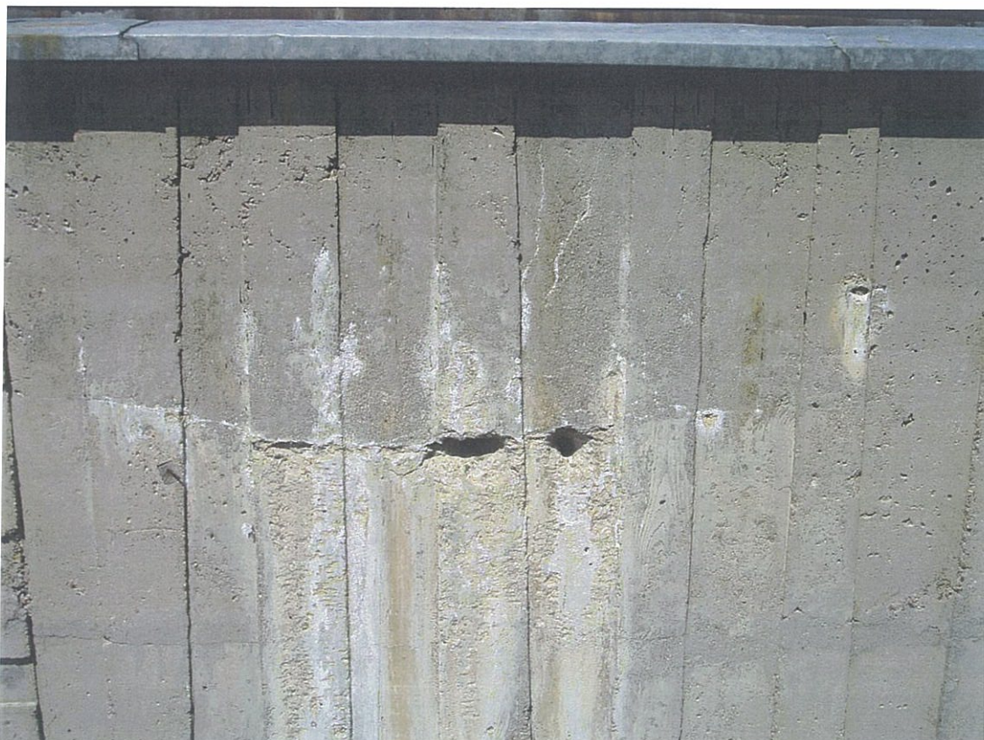
Fot. 55 Stan powierzchni żelbetowej południowej ściany elewacyjnej
