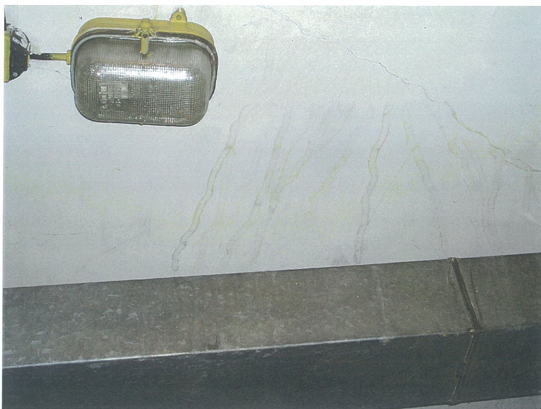
Fot. 92 Pęknięcia płyty sufitu i ślady zacieków przy instalacji elektrycznej
