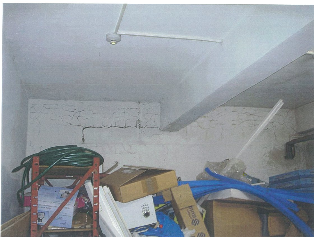
Fot. 78 Siatka spękań na ścianach pomieszczeń z aparaturą klimatyzacyjną
