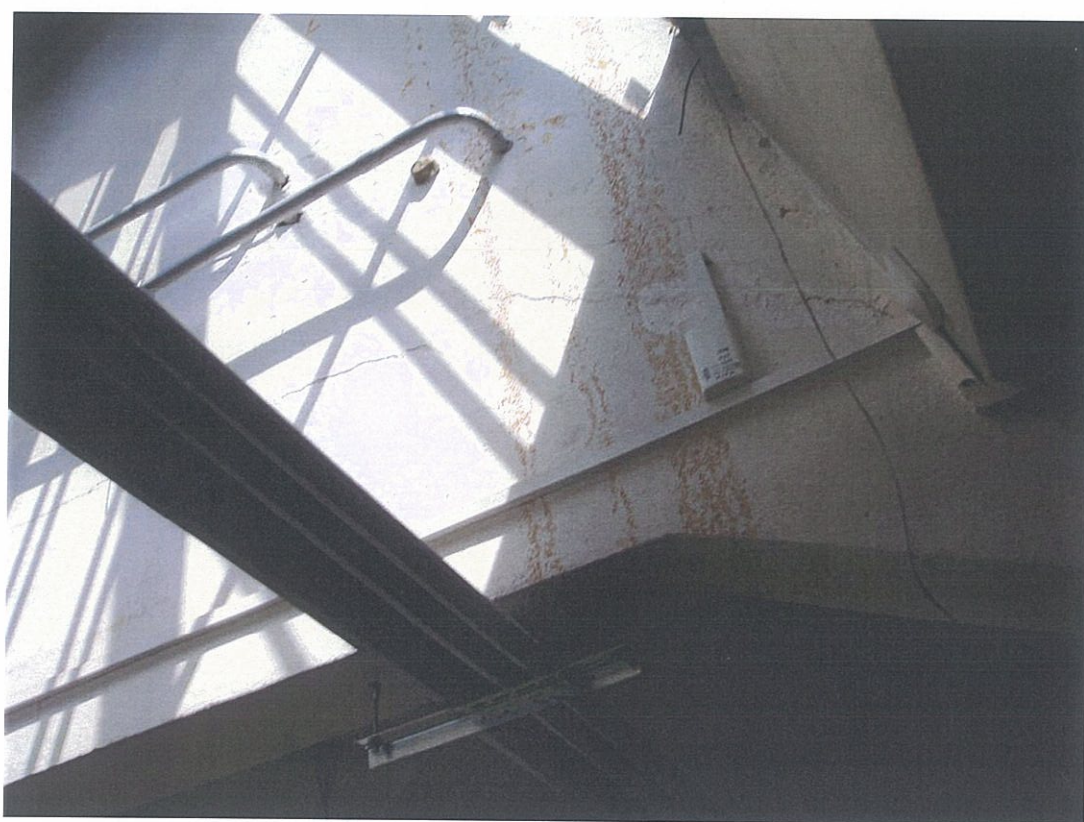
Fot. 74 Zacieki na ścianie wewnętrznej podstawy świetlika
