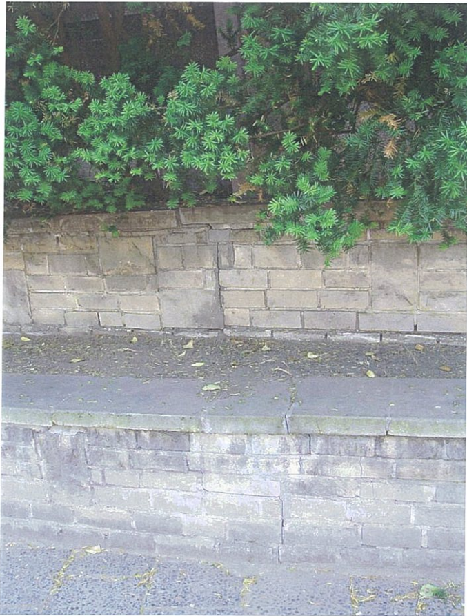
Fot. 43 Pęknięcia murku rabaty
