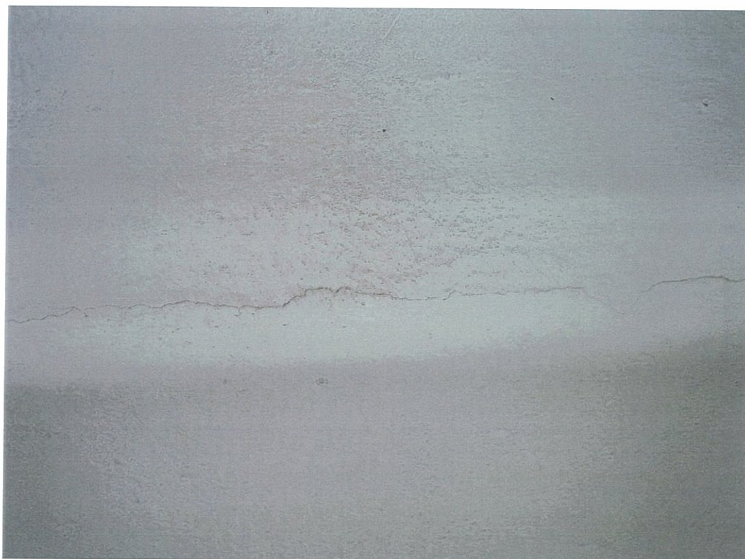
Fot.24 Ślady przemarzania i zarysowanie na styku krawędzi płyt
