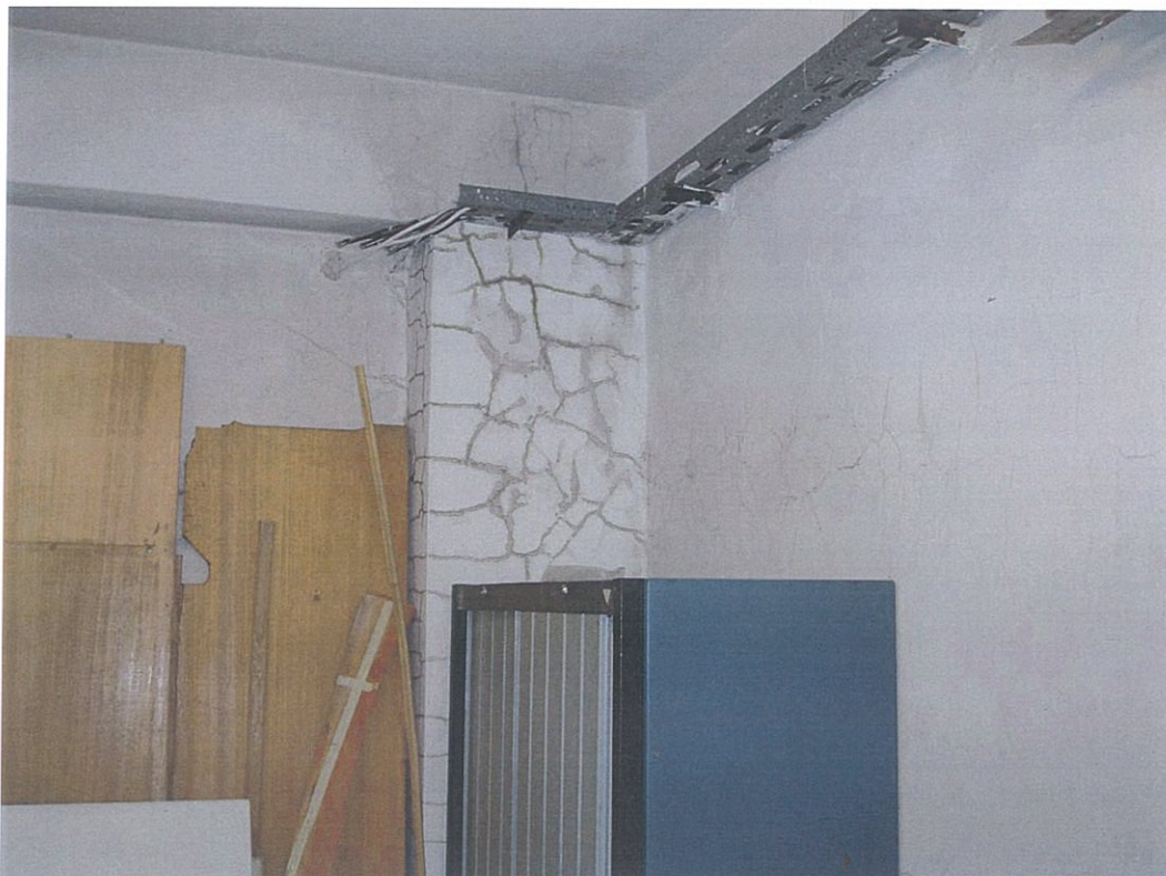
Fot.79 Siatka spękań na ścianach pomieszczeń z aparaturą klimatyzacyjną
