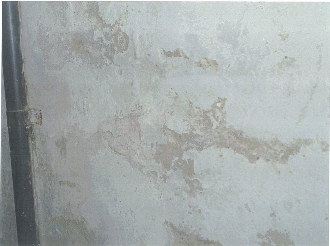
Fot. 83 Ślady podsiąkania wód gruntowych i przemarzania ściany
