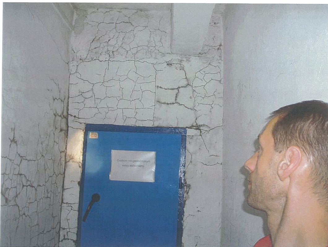
Fot. 77 Siatka spękań na ścianach pomieszczeń z aparaturą klimatyzacyjną
