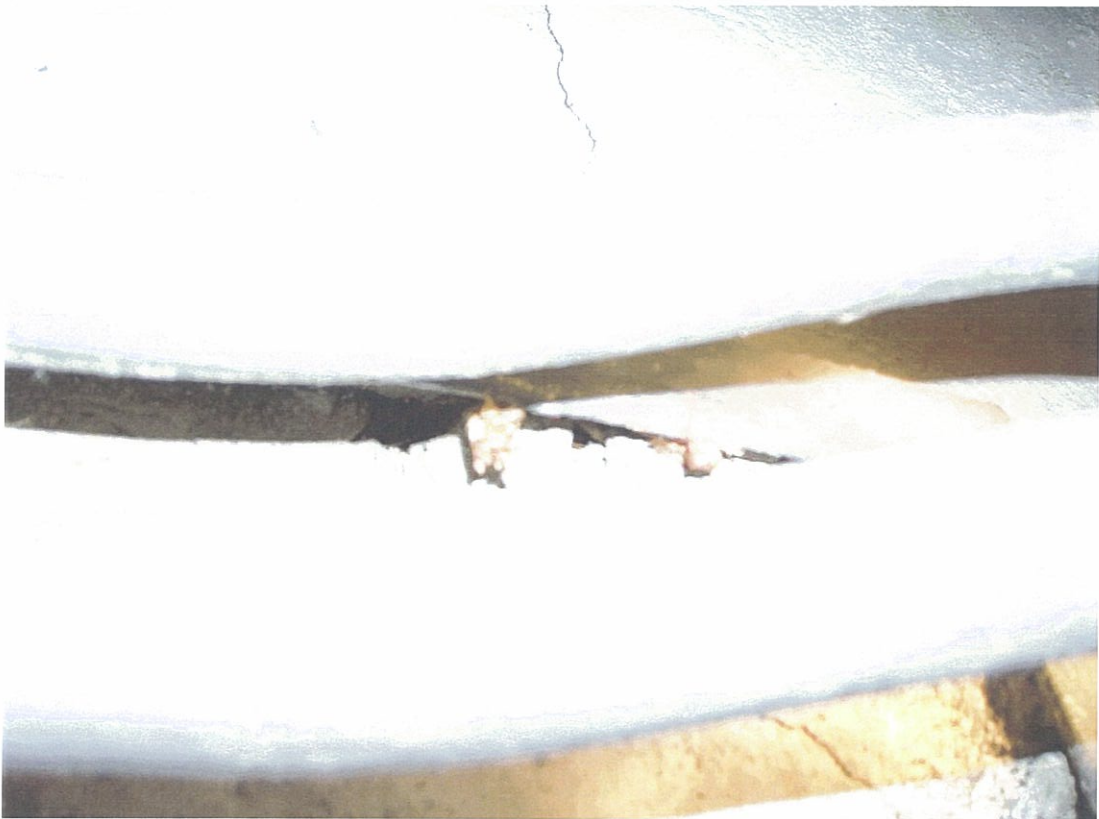
Fot.28 Przechodzące przez ścianę korzenie i pęknięcie rozsadzonej korzeniami płyty
