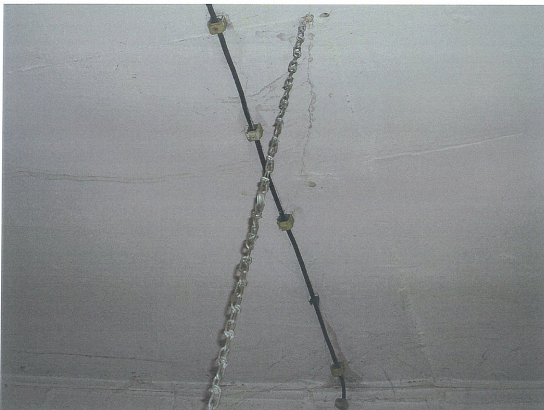
Fot. 91 Pęknięcia płyty sufitu i ślady zacieków przy instalacji elektrycznej
