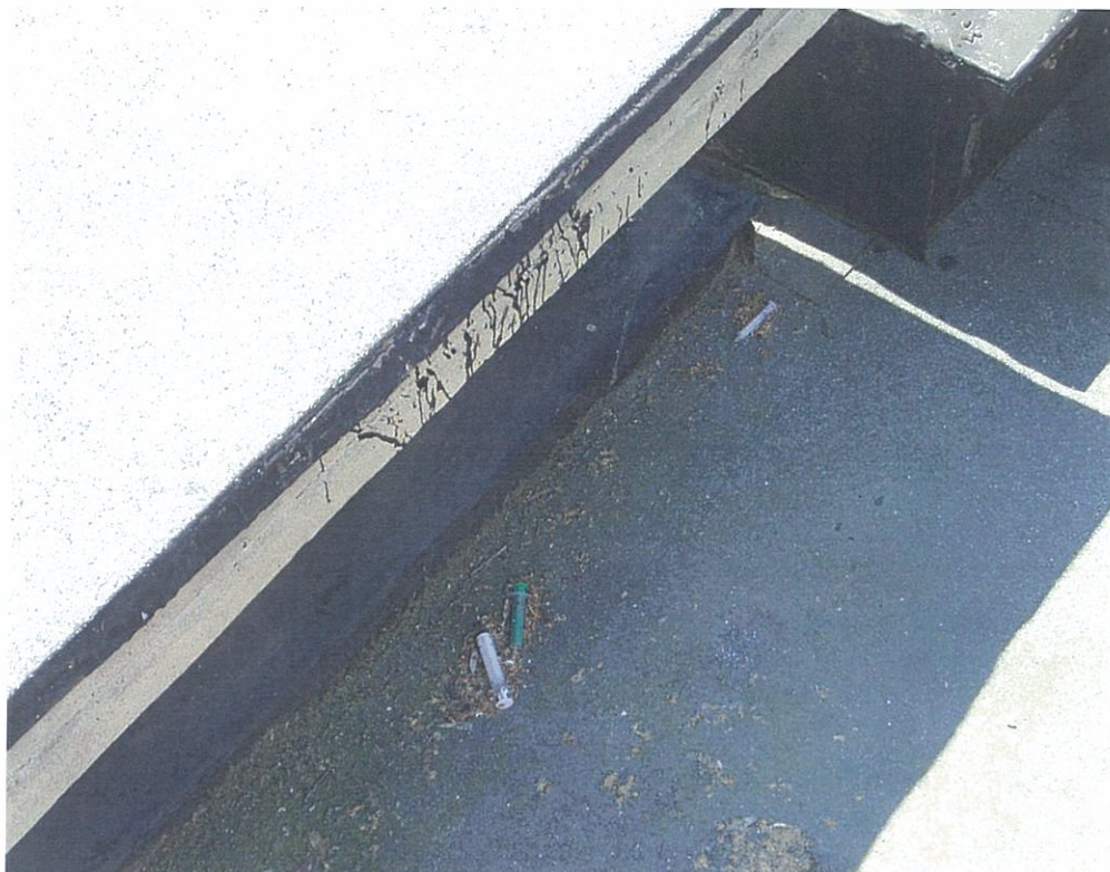
Fot. 47 Strzykawki – pozostałość po narkomanach – na dachu przybudówki technicznej
