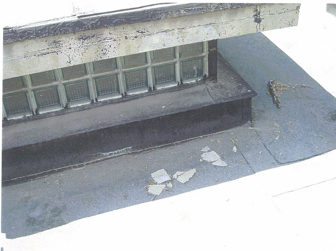
Fot. 65 Uszkodzenia tynku na krawędzi dachu świetlika
