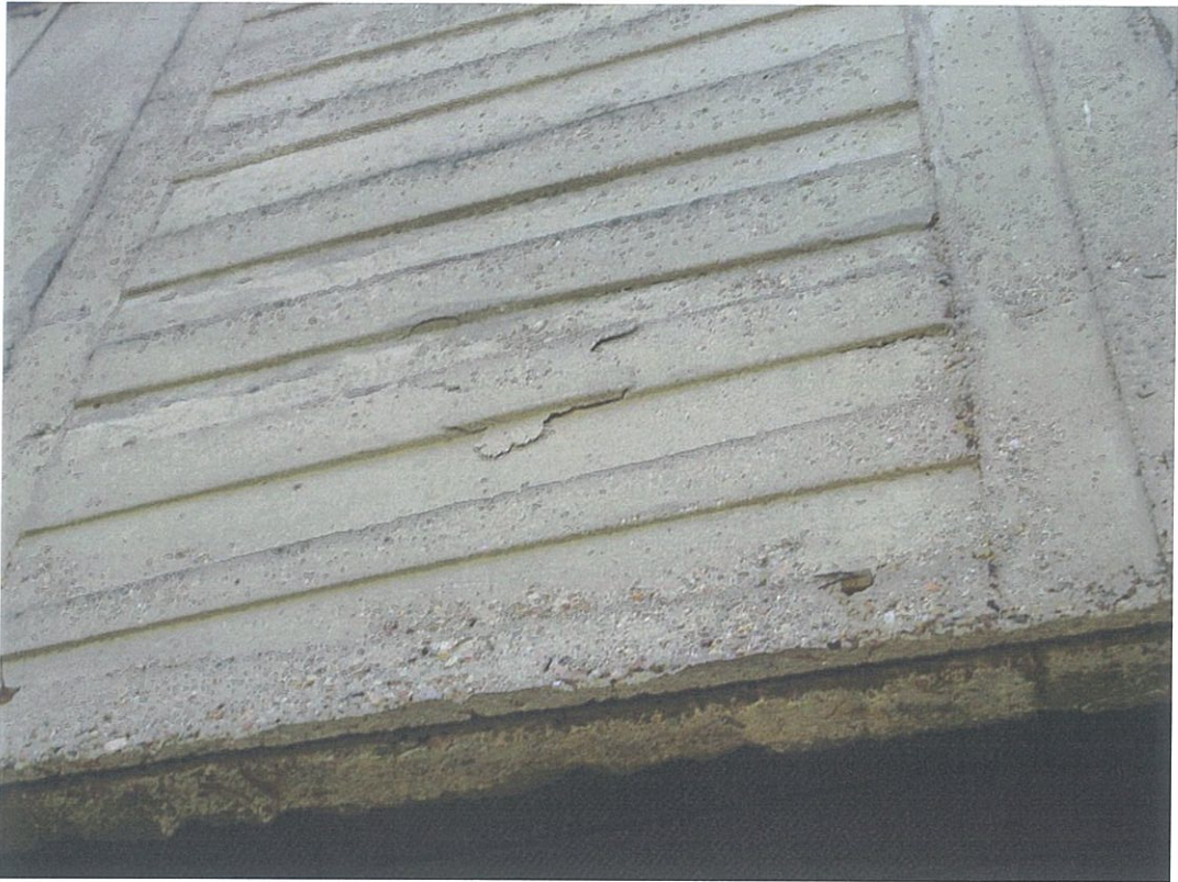
Fot. 53 Stan powierzchni żelbetowej północnej ściany elewacyjnej
