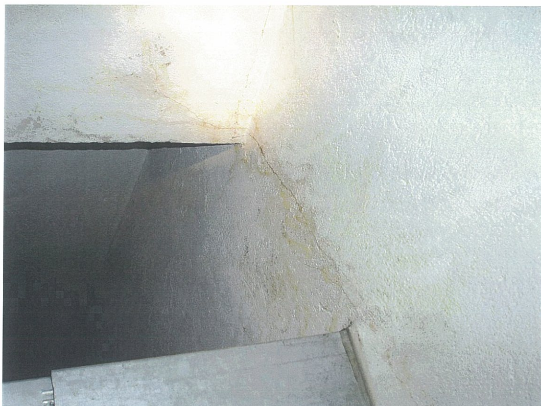
Fot.72 Zaciek na pęknięciu odpajającym podstawę świetlika dachu
