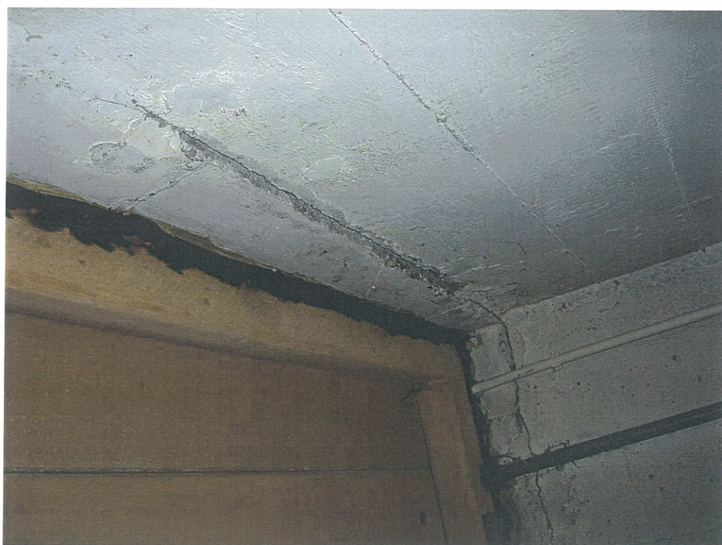
Fot.40 Widoczne świeże zacieki na spękaniach przy drzwiach korytarzyka wyjściowego z podziemi budynku rotundy
