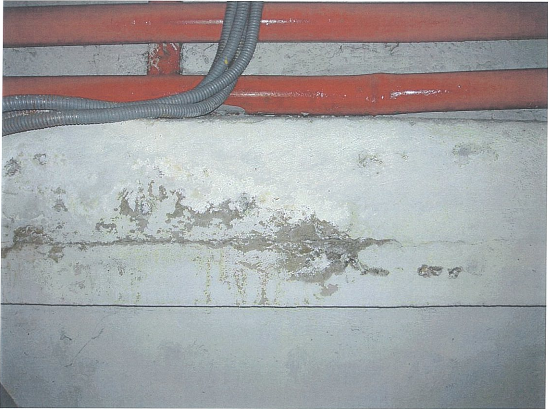
Fot.41 Ślady penetrowania wód gruntowych w korytarzyku wyjściowym
