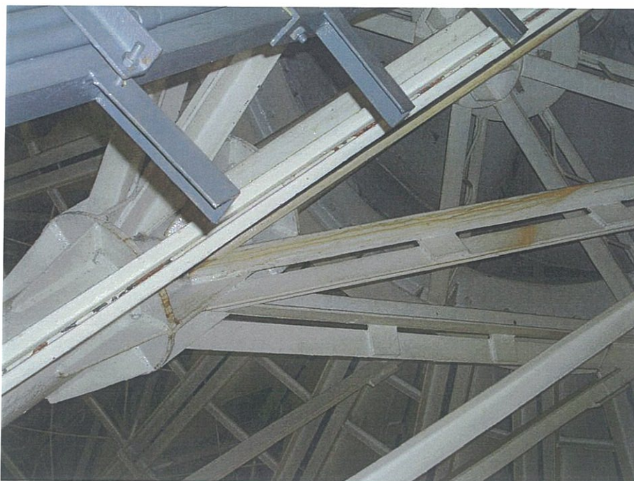
Fot. 11 Uszkodzenia korozyjne konstrukcji stożka („5” – rys. 1)
